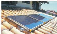
Coletor Solar Soletrol - Instalação Residencial
