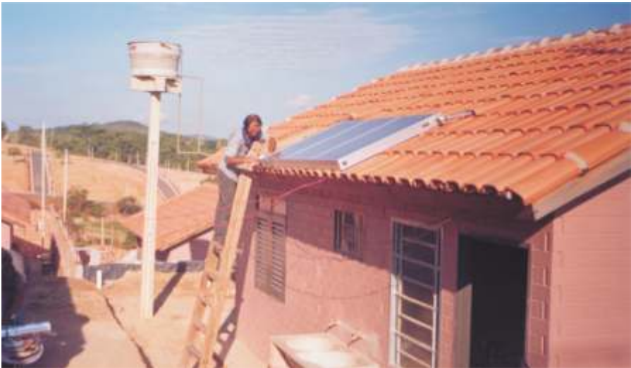
Aquecedor Solar Soletrol no projeto Sapucaias - Contagem - MG
