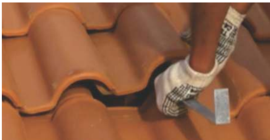
Suporte tipo cinta metálica de fixação do coletor solar sendo introduzido no telhado
