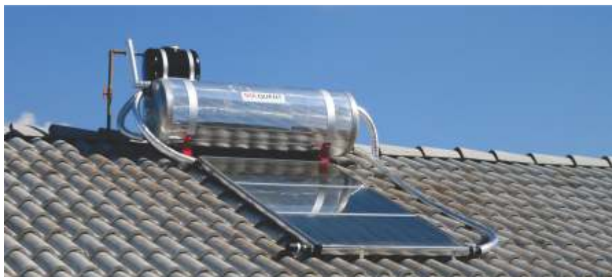
Aquecedor Solar Compacto sobre o telhado
