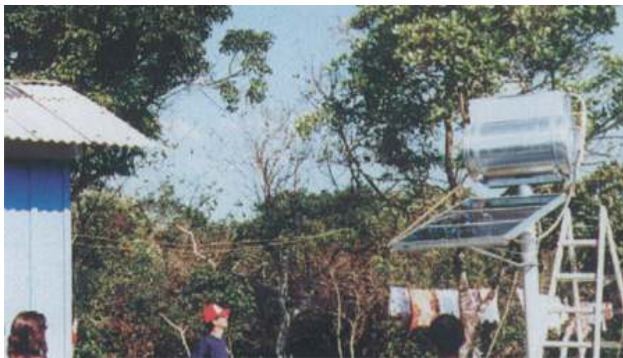
Aquecedor Solar POPSOL na Ilha do Mel - PR
