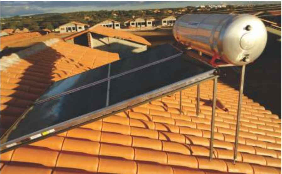
Aquecedor Solar sobre telhado sem orientação adequada e com suportes de correção
