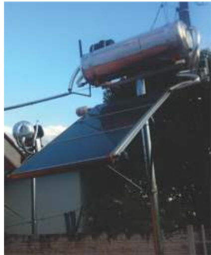
Sistema de Aquecimento Indireto Copel Energia - PR
