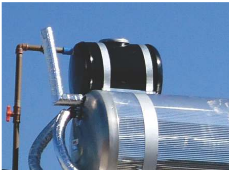
Caixa Quebra-Pressão em Aquecedor Solar Compacto
