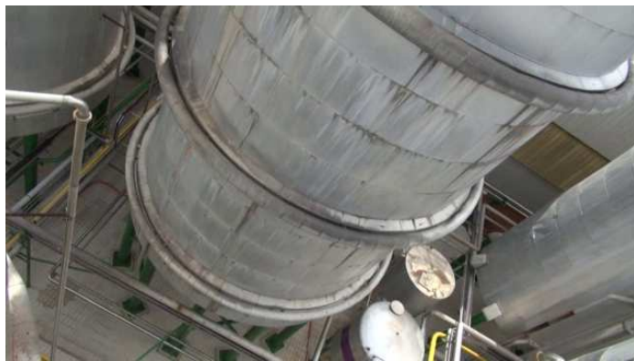
Reservatório Térmico Vertical
