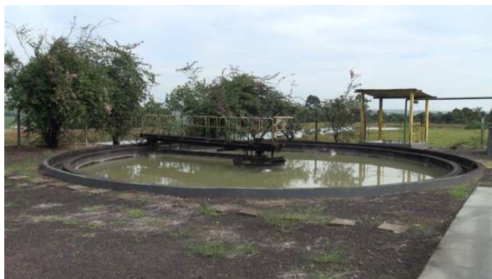
Tratamento de Efluentes
