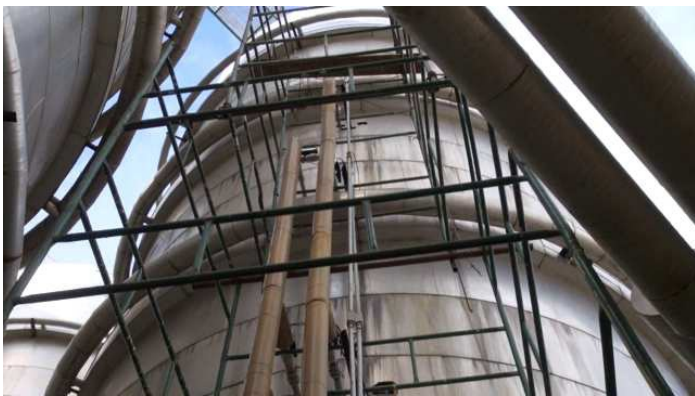
Reservatório Térmico Vertical
